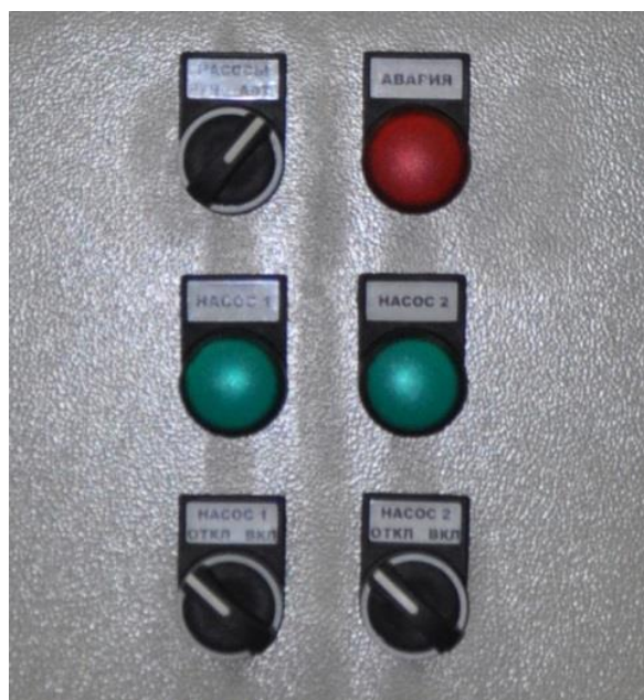
Рис.2. Панель управления насосами отопления
