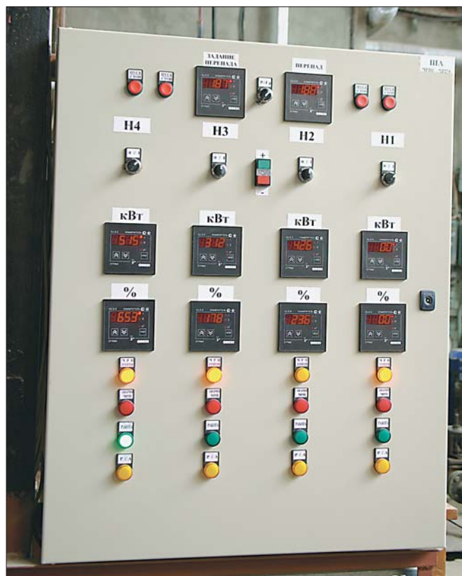
Фото 1. Щит управления сетевыми насосами
