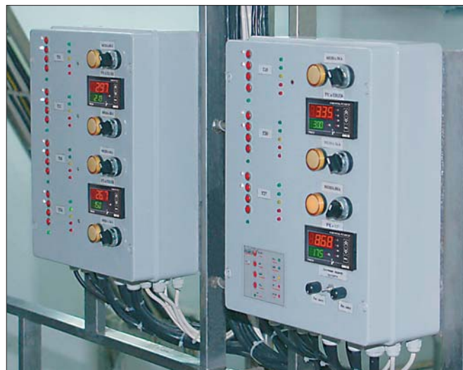
Фото 3. Шит управления на базе измерителя двухканального с универсальными входами ОВЕН ТРМ200 и измерителя-регулятора двухканального с универсальными входами ОВЕН ТРМ202, установленный на ЗАО «Кореновский молочно-консервный комбинат»
