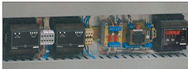
Рис. 1. Приборы компании ОВЕН, установленные на Кореновском молочно-консервном комбинате
