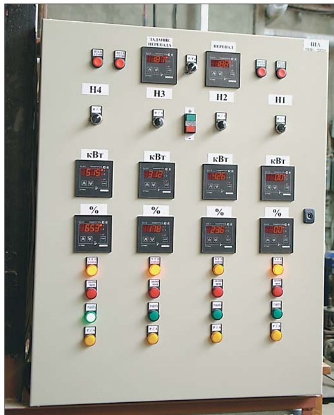
Фото 1. Щит управления сетевыми насосами
