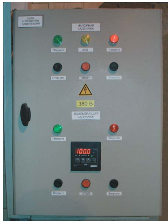
Фото 2. Шкаф управления задвижками
